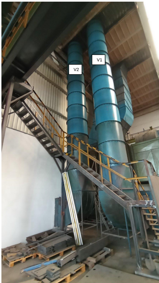
Výduchy striekacej kabíny č. 3
