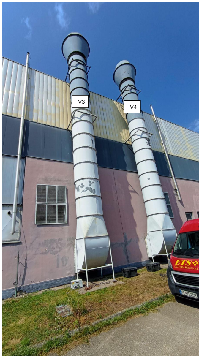
Výduchy striekacej kabíny č. 1
